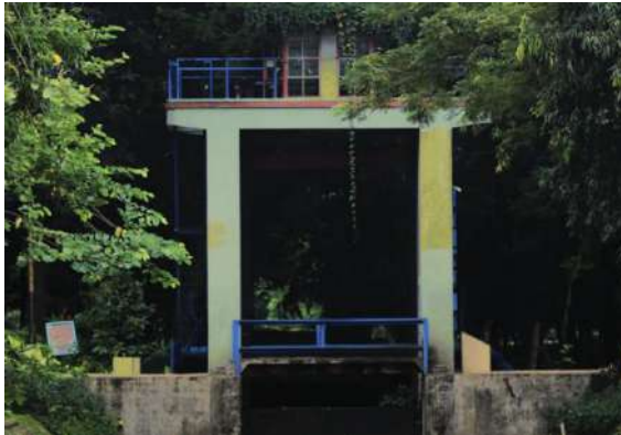
Gambar 9.24. Pintu Air Getek yang berada di atas Kanal Mookervaart
