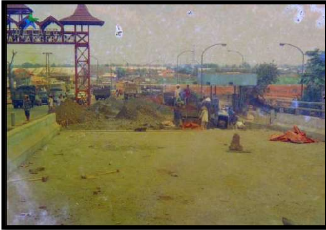
Gambar 4.4. Pembangunan jembatan penghubung di perbatasan antara Kabupaten Tangerang dan Kota Tangerang pada tahun 1995 di sekitar wilayah Karawaci. Sumber: Khastara Perpunas
